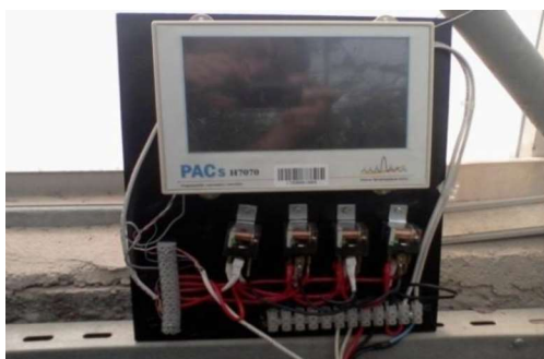
شکل ۳. ایستگاه فرمان نصب شده در گلخانه
